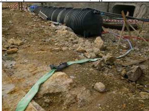
Figura 3 - Descarga de água residual industrial não tratada na Tomada de Água (31/08/2017)
